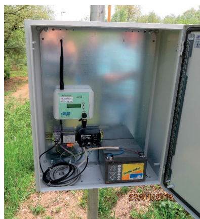
Slika 2. Hidrološka stanica (HS Dabar)
