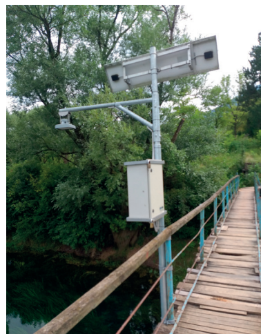
Slika 4. Hidrološka stanica s radar senzorom (HS Klokot)
