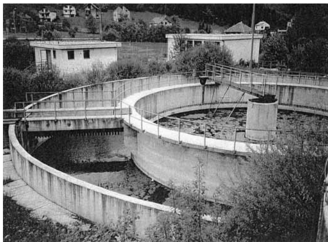
Bioaeracioni bazen i naknadni taložnik
