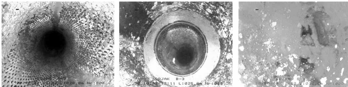
Fotografije unutrašnjosti bunara (stanje "čistog" dijela filtera, redukcija na 28.0 m, zona zapreke na 38.0 m)
